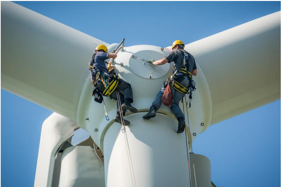
Hình 1.1: Công nhân tại trang trại điện gió làm việc trên cao với rủi ro cao khi thiếu PPE phù hợp.
